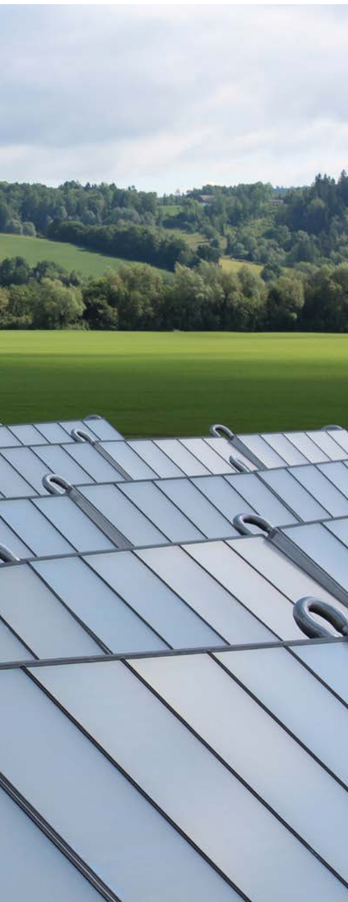
Solfangeranlegget til Akershus EnergiPark på Lillestrøm går snart inn i sitt femte driftsår, og erfaringene hittil har vært positive. Foto: Norsk Fjernvarme
